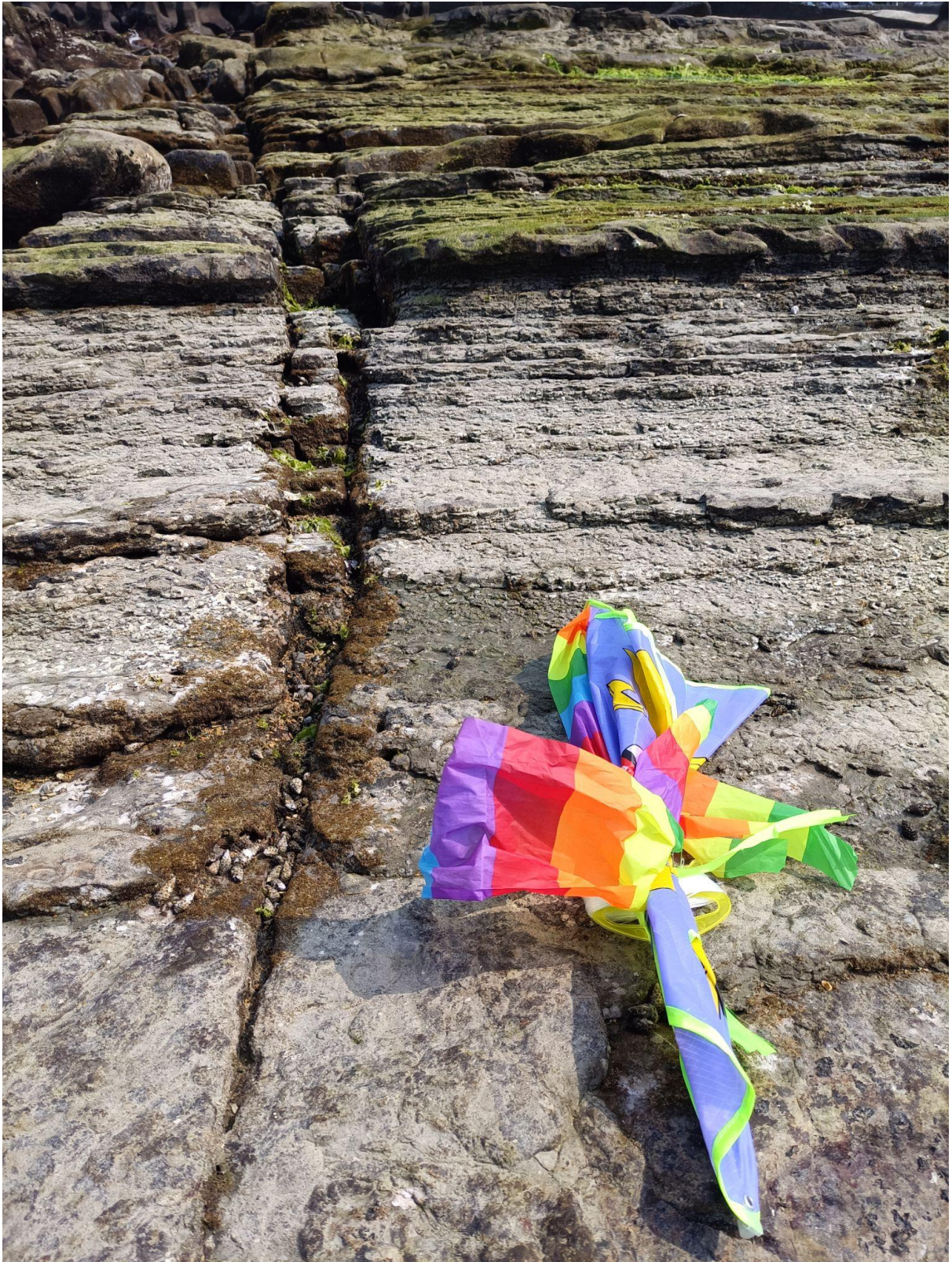
圖10 潮境公園南端海蝕平台，地形抬升導致露頭成階梯狀(風箏長約50公分)，斷層入侵
